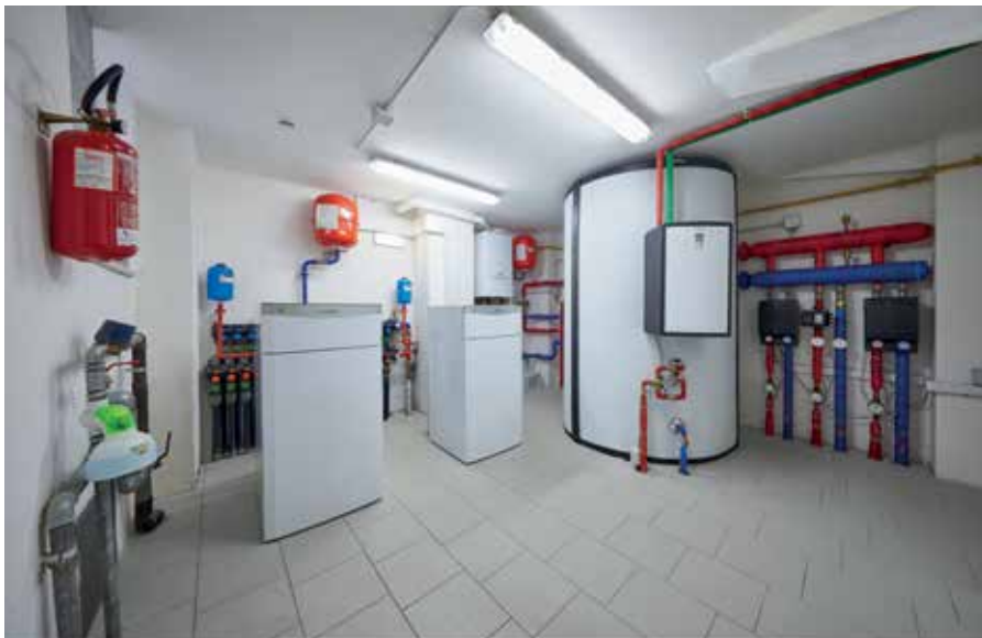
Pohľad do technickej miestnosti – v popredí sú dve tepelné čerpadlá Vaillant flexoTHERM exclusive typu zem – voda, vzadu závesný kondenzačný kotol ecoTEC plus VU a vpravo multifunkčný zásobník Vaillant allSTOR exclusive.
